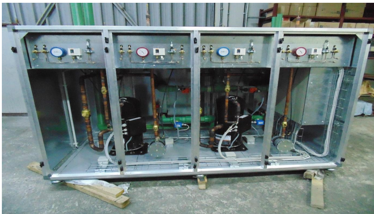
Фиг.1 Снимка на разглеждания водоохлаждащ агрегат
